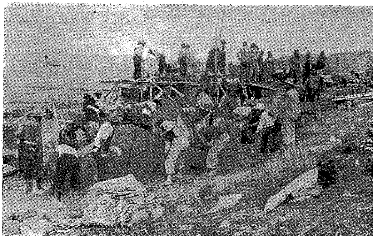
Contribución de la comunidad a la construcción del reservorio de Calapuja — Puno.
