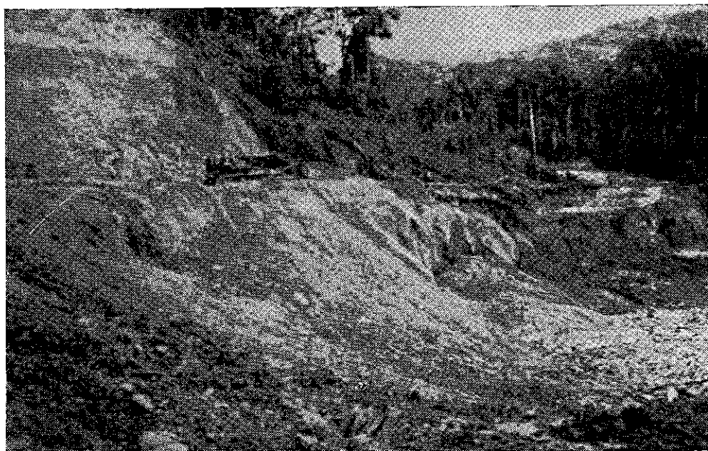
Un aspecto de los derrumbes producidos en la carretera Atalaya-Itahuanía-Manu.
