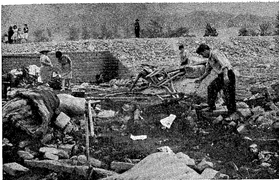
Hasta los escombros de esta emergencia llegó la rápida ayuda de la JAN.
