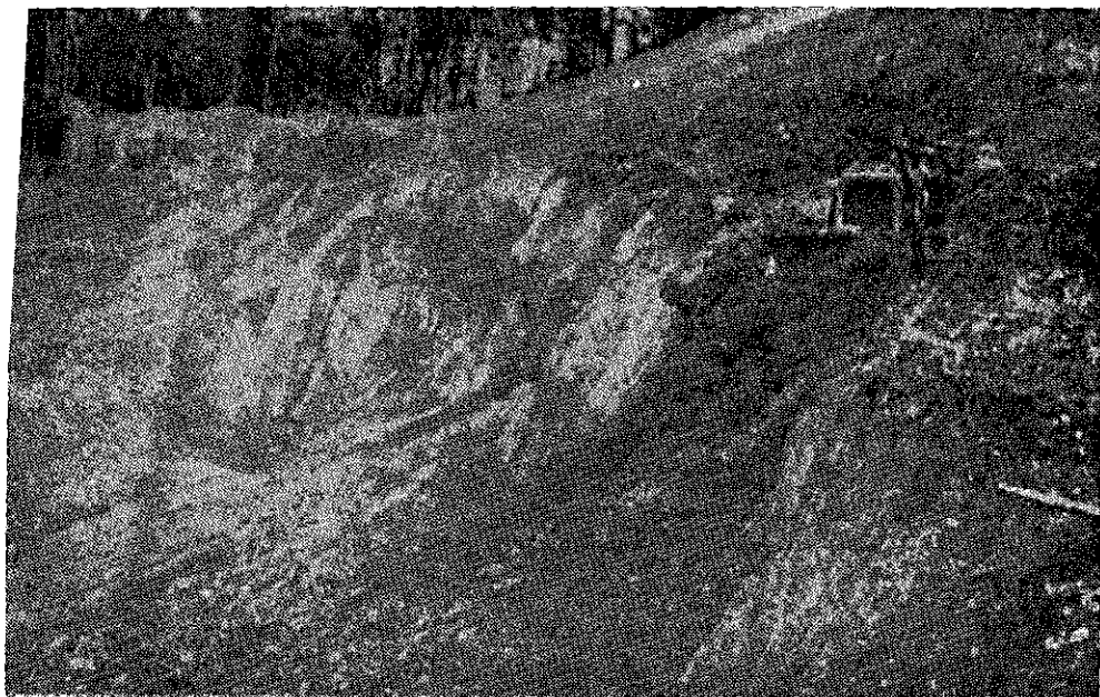
Aspecto que presenta el terreno arcilloso después de una pequeña lluvia en la carretera Olmos-Río Marañón y que demuestra lo difícil del trabajo.
