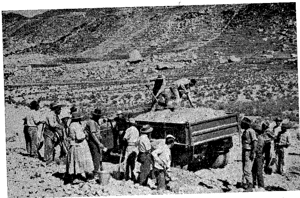
Movimiento de tierra para la construcción de una planta de tratamiento en Calapuja, Puno.
