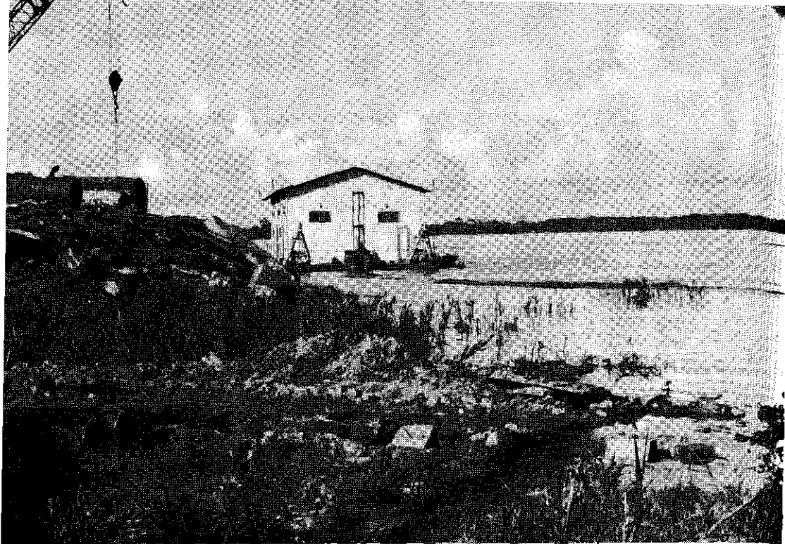
Captación de agua para su tratamiento y consumo, a través de una barcaza metálica flotante, correspondiente al plan nacional de SENAPA, en la selva central.
