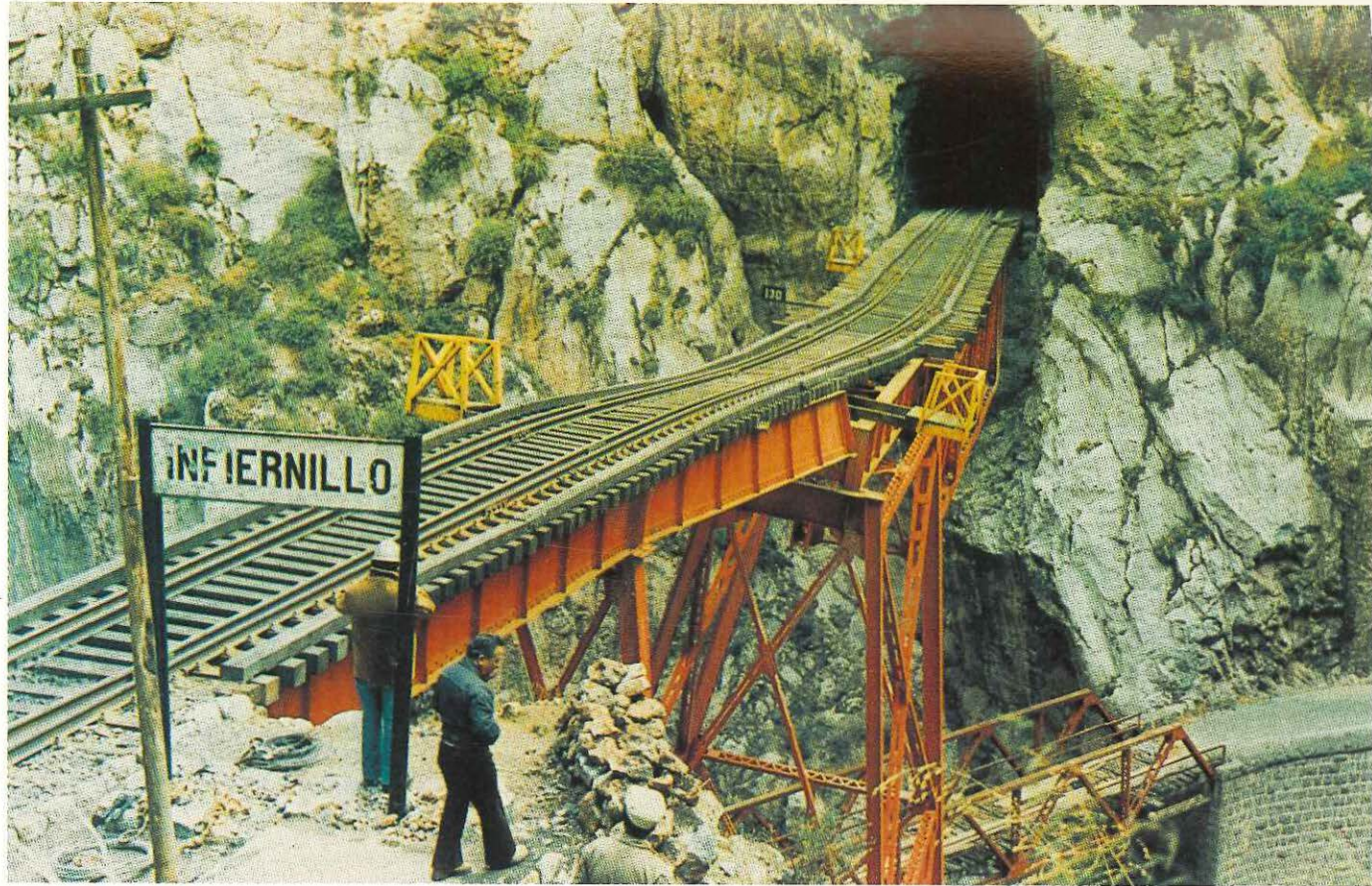
Puente del Infiernillo, monumental obra de ingeniería ferroviaria en la vía central. Se aprecia la torre inclinada, tramos con vigas de alma movidos y la línea férrea desalineada tras el atentado criminal terrorista del 23 de junio pasado.
