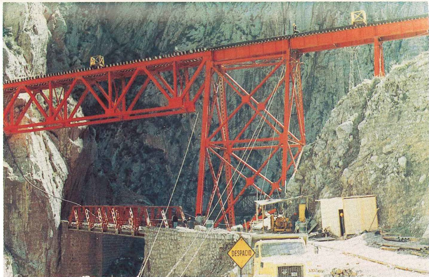
Perspectiva del puente del Infiernillo vuelto a su posición original, después de las reparaciones efectuadas por técnicos de ENAFER para restablecer el tránsito ferrocarrilero a la región central, entre Lima y Huancayo.
