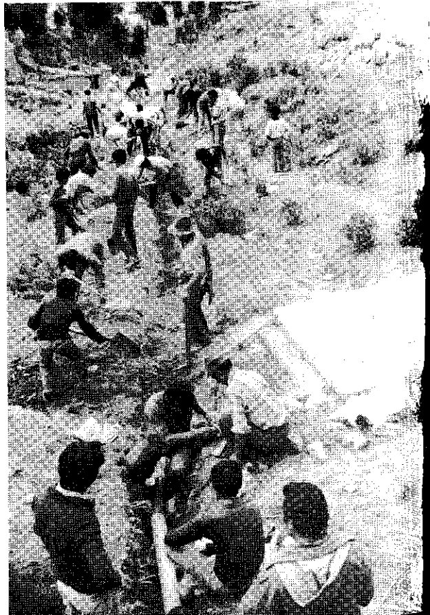
Obra de cooperación popular para instalar el servicio de agua potable en el barrio de Buenavista, Cusco.
