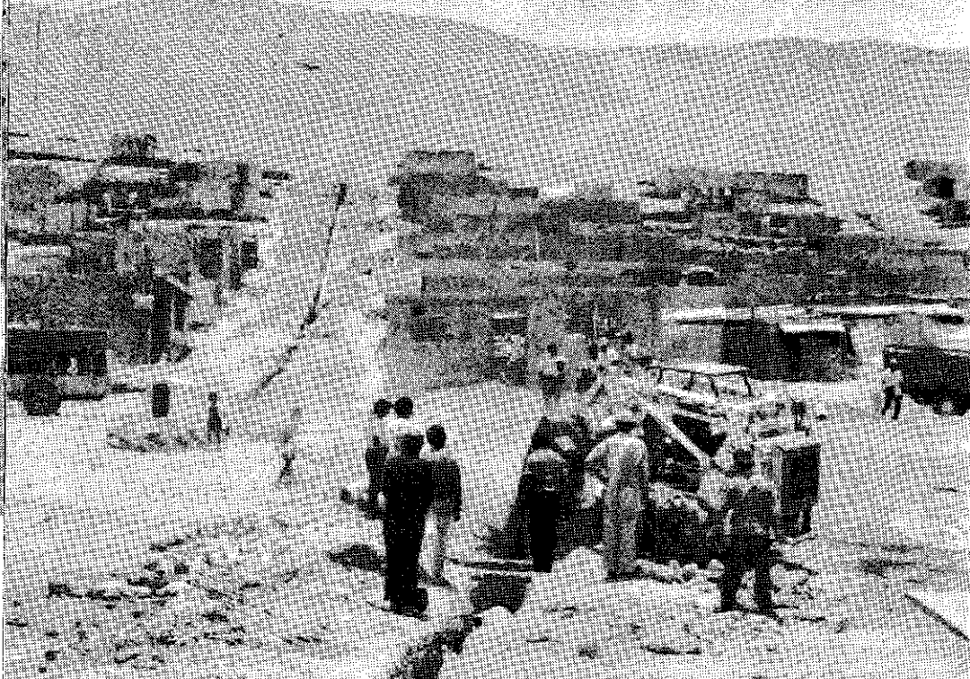
Instalación de red matriz de desagüe en el pueblo joven John F. Kennedy de Moquegua. La obra beneficiará a 75 familias.
